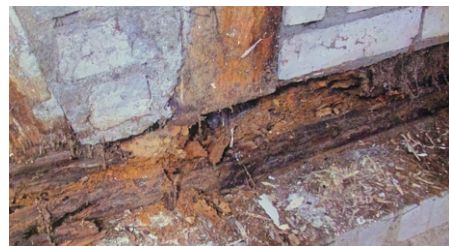
Verrottete Balken im Fundament gefunden
