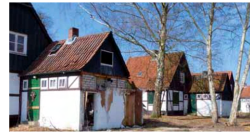
Zerfallene Landarbeiterhäuser (von hinten), der Zustand 2011 ist prekär
